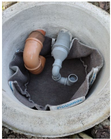
Filter für den Zulauf in die Zisterne: Die Anlage wurden 1994 in Eigenleistung eingerichtet und wird seitdem mit großer Zufriedenheit genutzt. Der Filter wird je nach Verschmutzung oder Starkregenereignisse 2 bis 3 Mal jährlich gereinigt. Foto: Manfred Röhner
